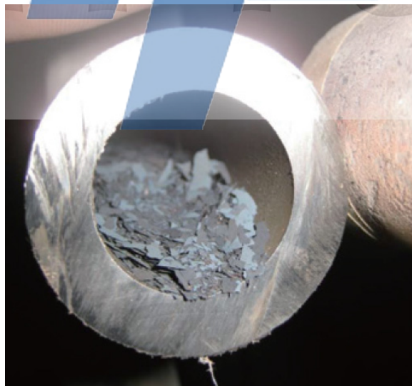
圖 4-3-1 爐管蒸汽側氧化
